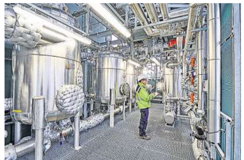
In der LX-Demonstrationsanlage werden noch energiereiche Gärreste zweifach aufbereitet.
